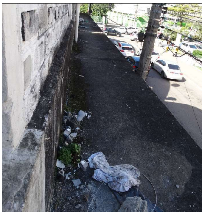
Figura 11 - Marquise em mau estado de conservação
