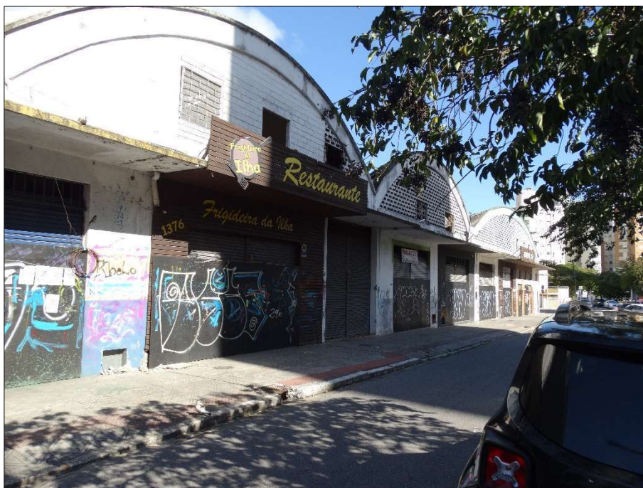
Figura 14 - Degradação das fachadas.
