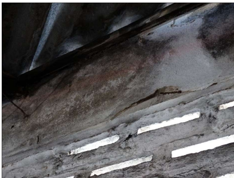
Figura 17 - Armadura exposta na cobertura.
