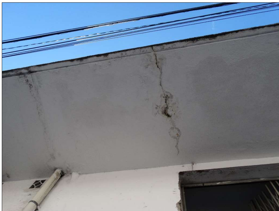
Figura 12 - Marquise com infiltração e fissuras.
