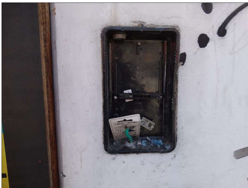
Figura 19 - Quadro elétrico desativado
