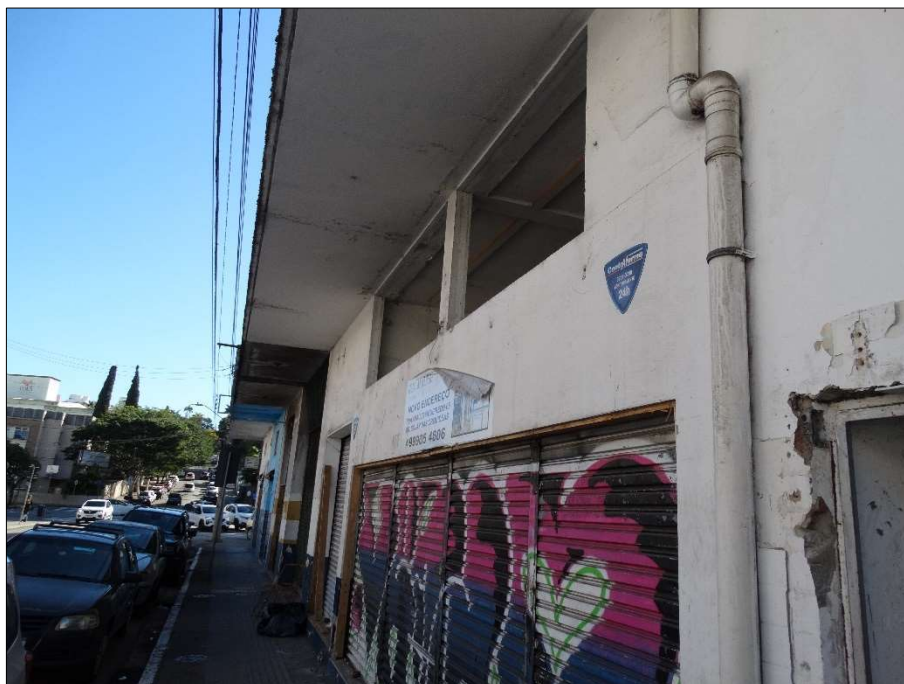
Figura 2 - Falta de isolamento.
