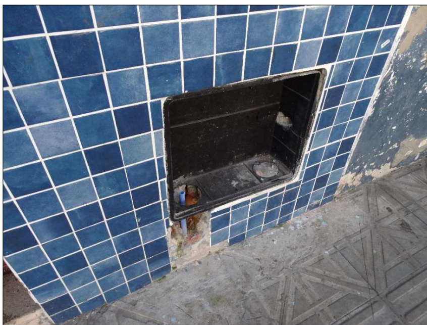
Figura 18 - Quadro hidráulico desativado.
